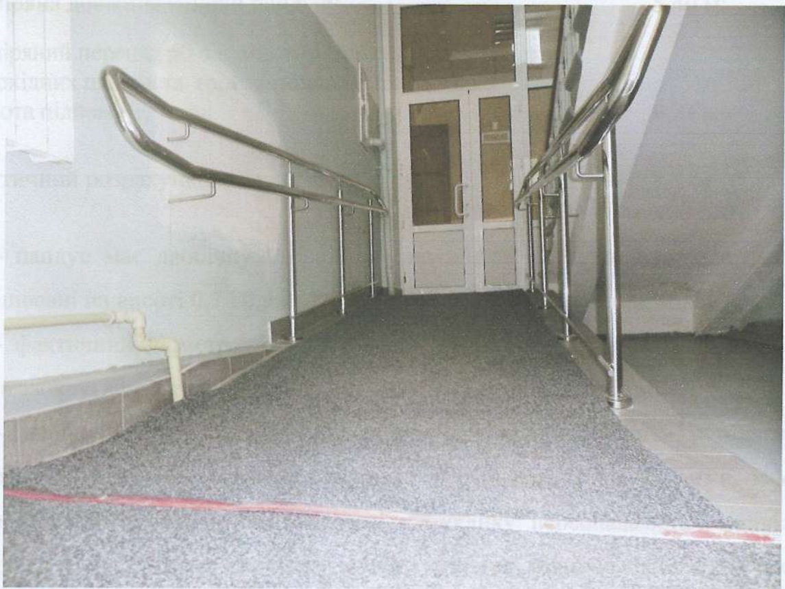
Фото 3.1 Загальний вигляд внутрішнього пандусу в будівлі головного навчального корпусу Миколаївського національного аграрного університету
